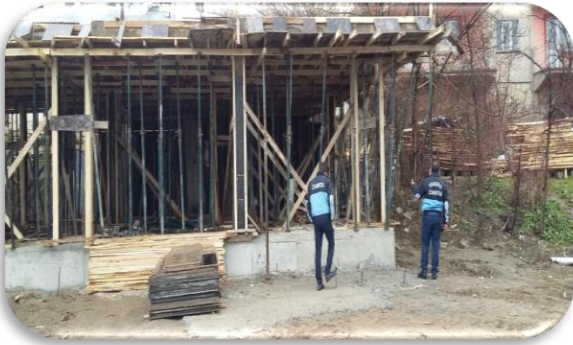
Kaçak Yapı ve İnşaatlar
